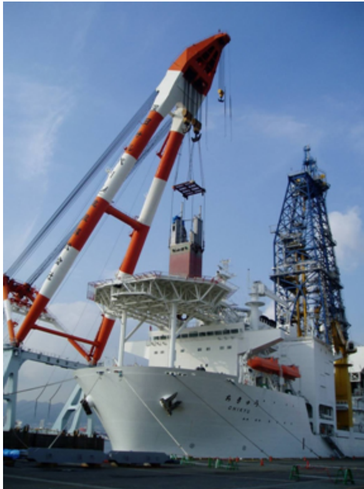
【写真1】 交換したギアを組み込んだアジマススラスタ（約250トン）を「ちきゅう」のヘリコプターデッキの開口部を通して船体に搭載する作業。4基のアジマススラスタについて写真のような工事を実施して搭載した。後部2基のアジマススラスタは造船所において修理を行った。
