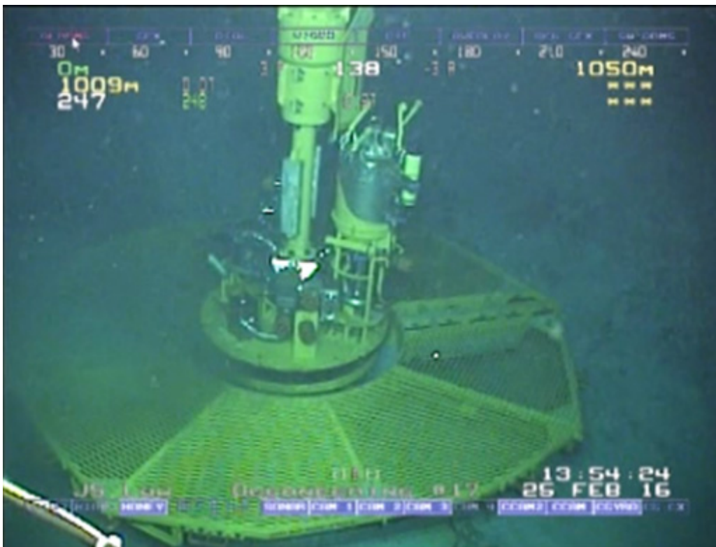
B:C9024に設置したモニタリング装置
