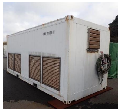
写真-1 20ft コンテナ型コンプレッサー
